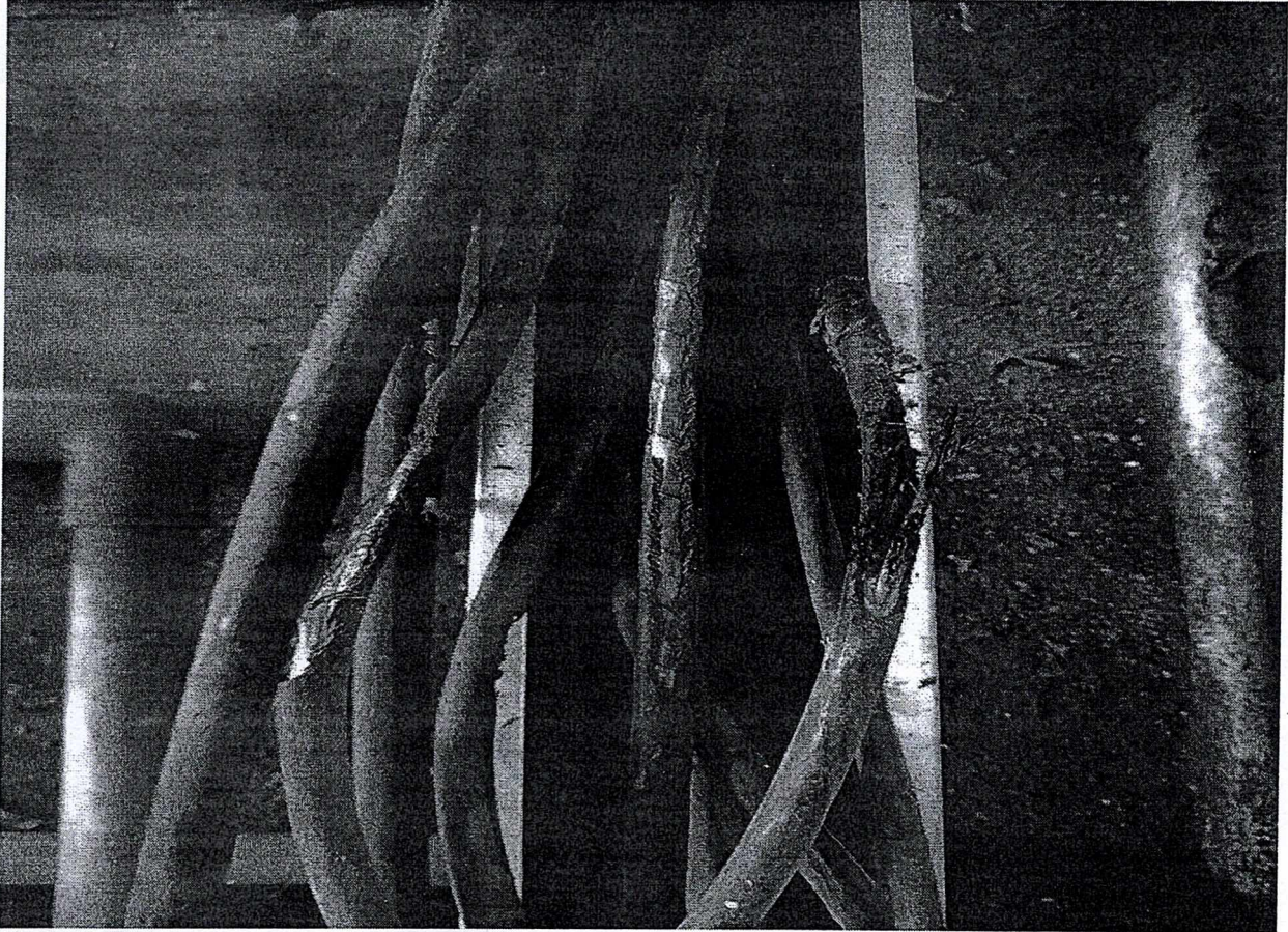
Hình ảnh sự cố dây điện bị chuột cắn đứt:
