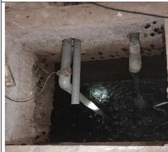
Bể ngầm chứa nước 50 m 3
