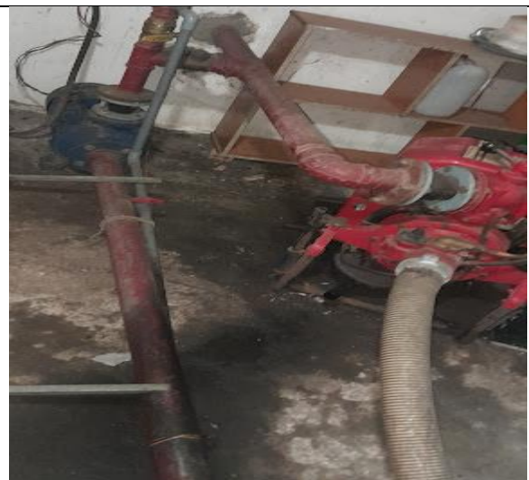
Máy bơm tại bể 90 m 3 của hệ thống PCCC
